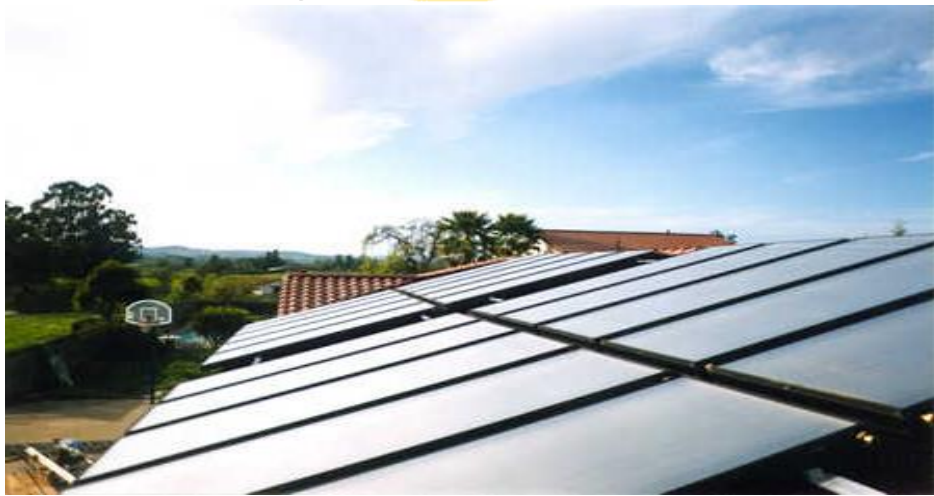
ทำน้ำร้อนจาก Solar Collector
