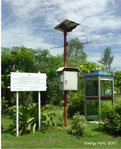
ระบบโทรศัพท์พลังงานแสงอาทิตย์
