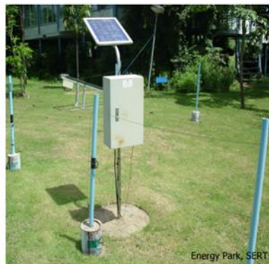
รั้วพลังงานแสงอาทิตย์
