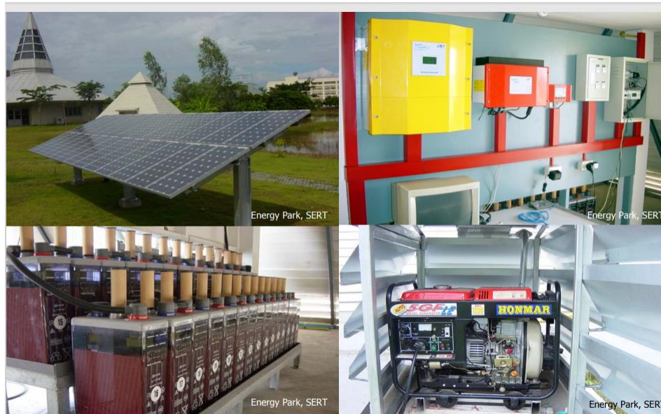
ระบบไฮบริด เซลล์แสงอาทิตย์/เครื่องกำเนิดไฟฟ้าดีเซล ณ โครงการสวนพลังงาน วิทยาลัยพลังงานทดแทน
